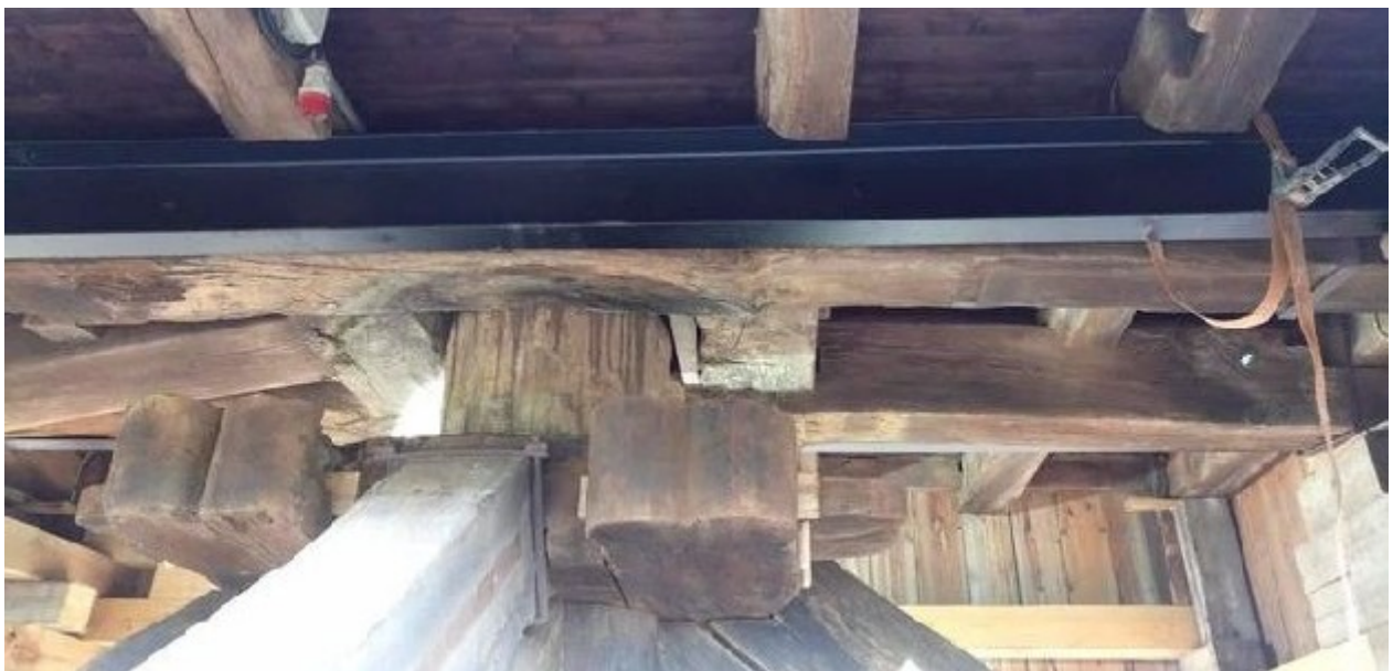
Bild 11: einer der beiden angebrochenen und durch einen U-Träger stabilisierten Fugbalken (vgl. auch Bild 2)
