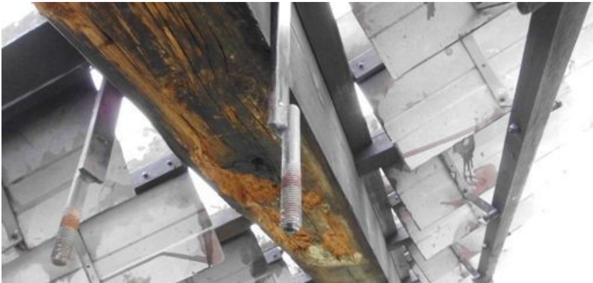
Bild 14: Pilzbefall an einem Windmühlenflügel an der Kontaktstelle zu dem 2017 demontierten Bruststück
